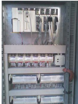
▲ Zostava nového riadiaceho systému spaľovne odplynov. Foto: P. Hudec
