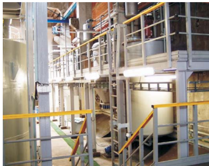
▲ Pohľad na časť zariadenia pre demerkurizáciu vodíka.
