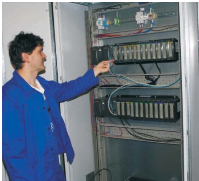
▲ Pracovník ASRTP pri oživovaní rozšíreného riadiaceho systému Honeywell investičnej akcie modernizácia a ekologizácia spracovania propylénoxidu.
